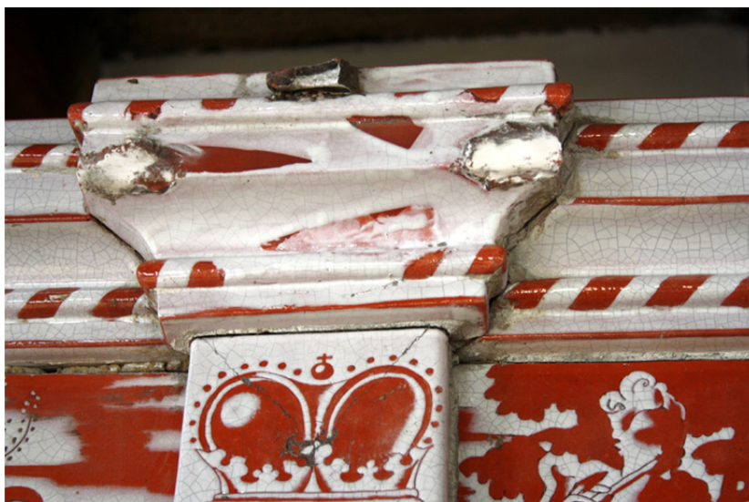
původní stav čelního sloupku
