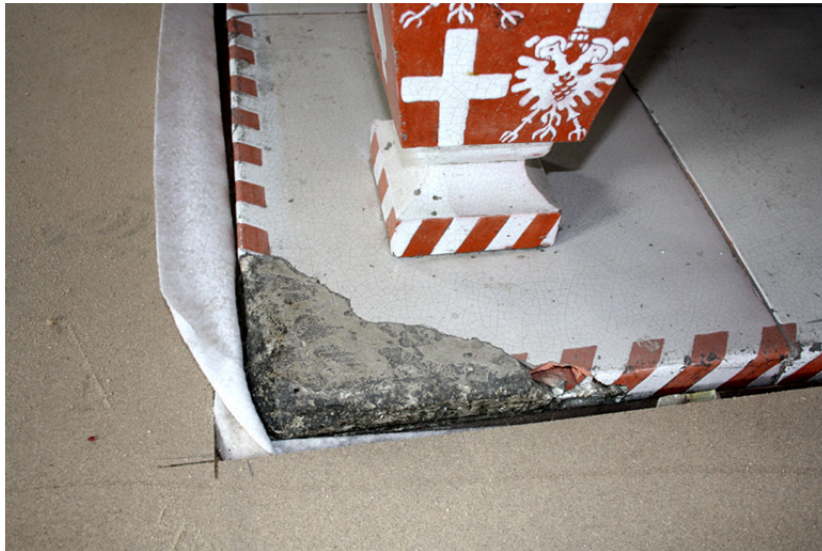
původní stav části dlažby
